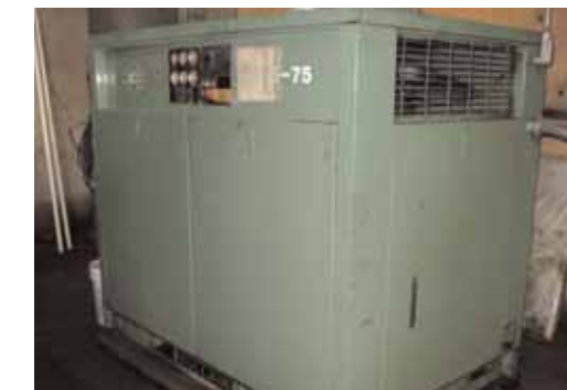
(2) Sullair 75 & 50 hp Air Compressors
