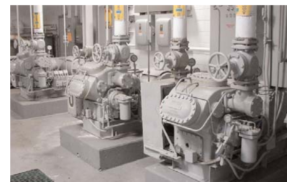
(5) Vilter 100hp & 50hp Ammonia Comp.
